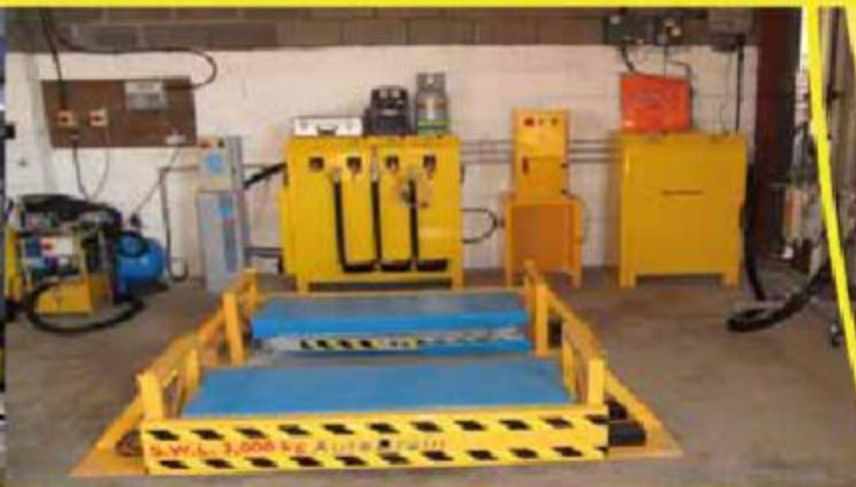
Instalaciones llave en mano
